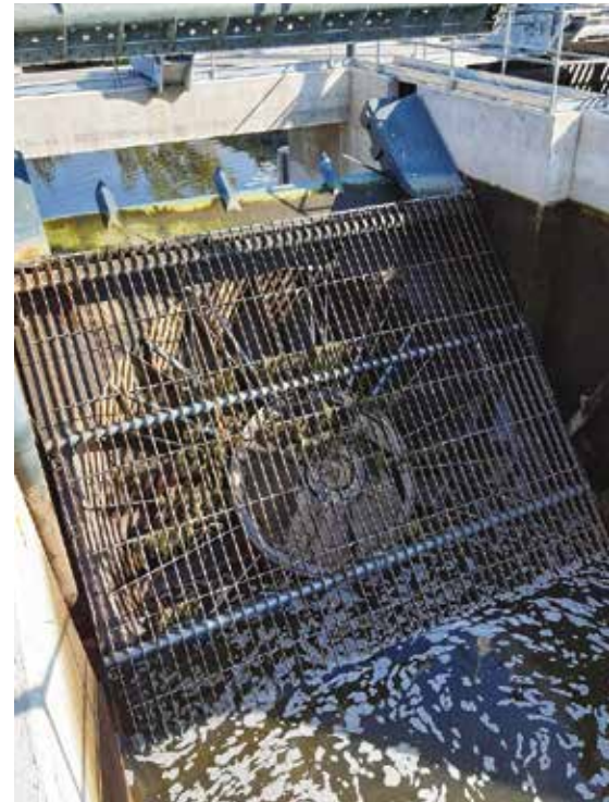
La turbine VLH, conçue en France, est totalement immergée et n'est pas visible sauf lors des opérations de maintenance comme sur ce cliché. Sa vitesse de rotation est excessivement lente permettant aux poissons de dévaler la Loire sans encombre.
